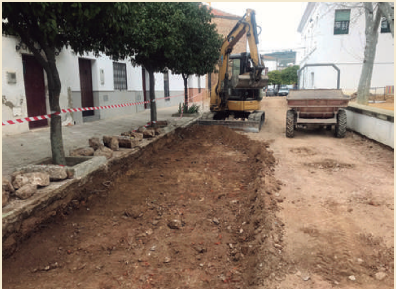
Figura 2. Proceso de excavación mecánica de los terrenos de base del antiguo pavimento de la calzada
