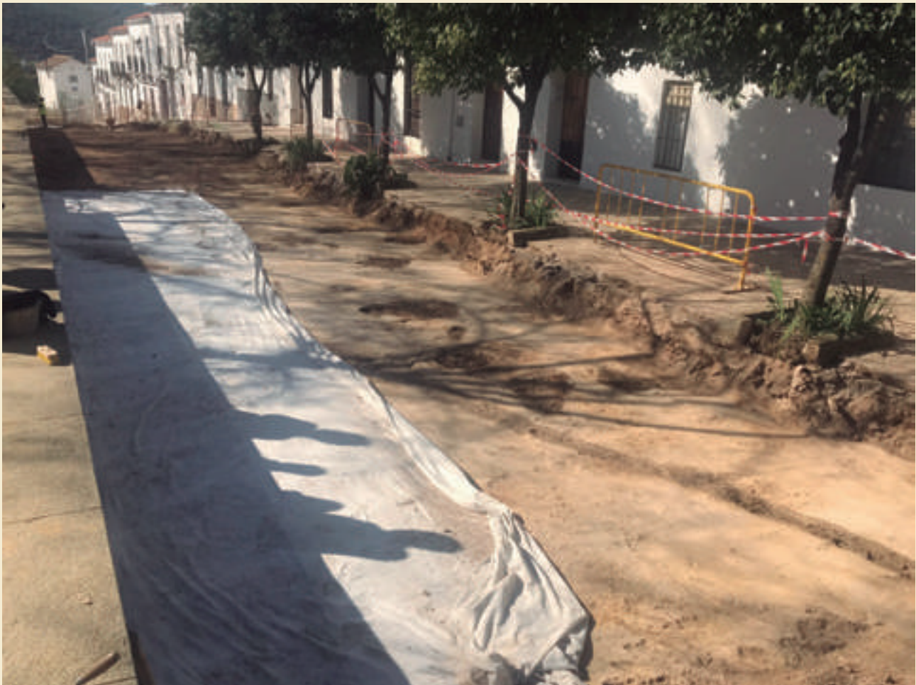
Figura 23. Proceso de colocación de lámina geotextil de protección en el sector central en el que se localizan varios silos
